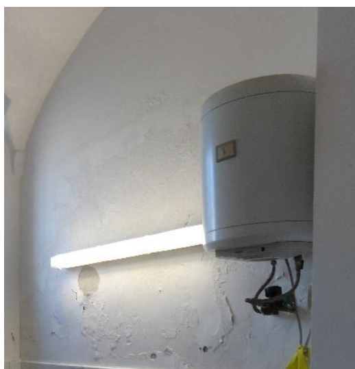
Figura 4.12 - Boiler elettrico - ACS servizi igienici
